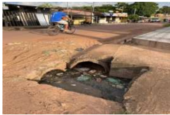
26ª Figura. Falta de dispositivo de drenagem. 3ª Rua a Liberdade 4,27478° S, 55,99292° O
