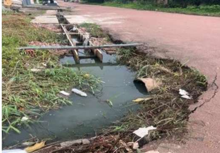
Figura 18 – Falta de dispositivo de drenagem: 7° Rua da Liberdade.
