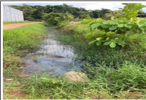
25ª Figura. Falta de dispositivo de drenagem. 3ª Rua da Liberdade 4,27421° S, 55,99196° O
