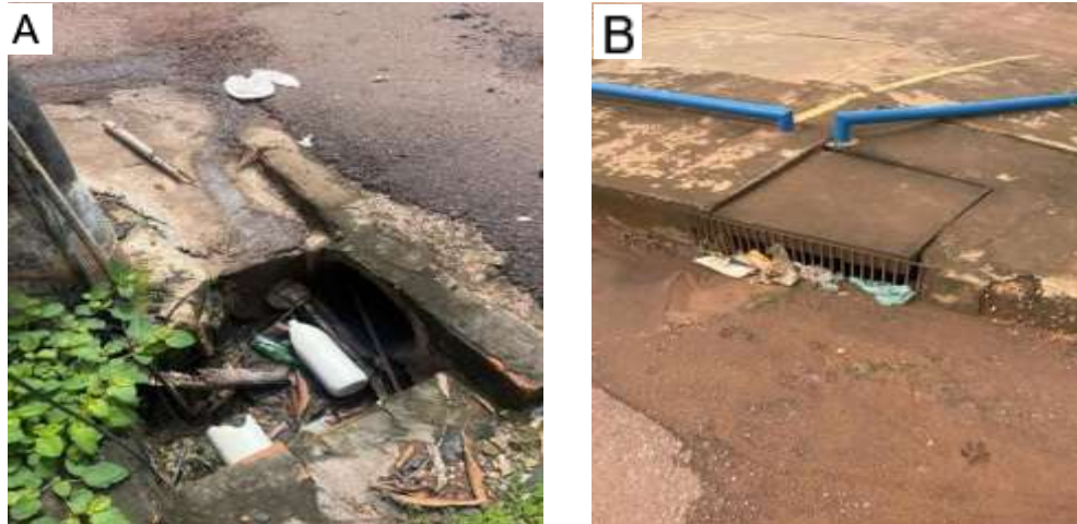
Figura 19 – Excesso de resíduo sólido no dispositivo de drenagem: 5° e 7° Rua da Liberdade BL n° 46 e 63.
