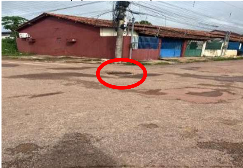
Figura 14 – Desconformidade do poço de visita em relação ao nivelamento da rua. 5ª Rua PV13.
