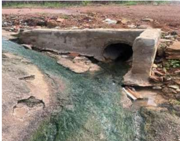
Figura 15– Demonstração da presença de fissuras estruturais na interface entre meio fio e sarjeta: 7° Rua da Liberdade.
