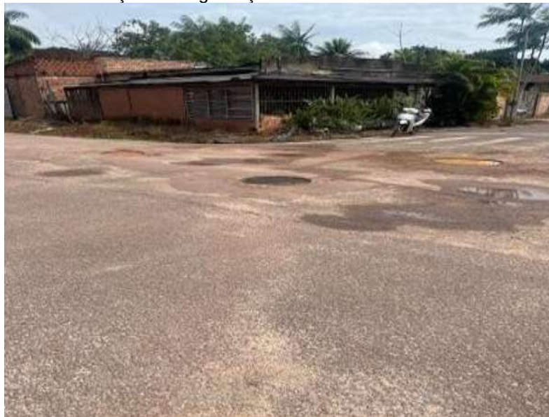
Figura 8 – Demonstração da degradação do asfalto: 6ª Rua da Liberdade PV nº14.
