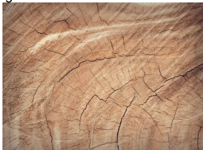
Figura 14 – Rachadura na madeira
