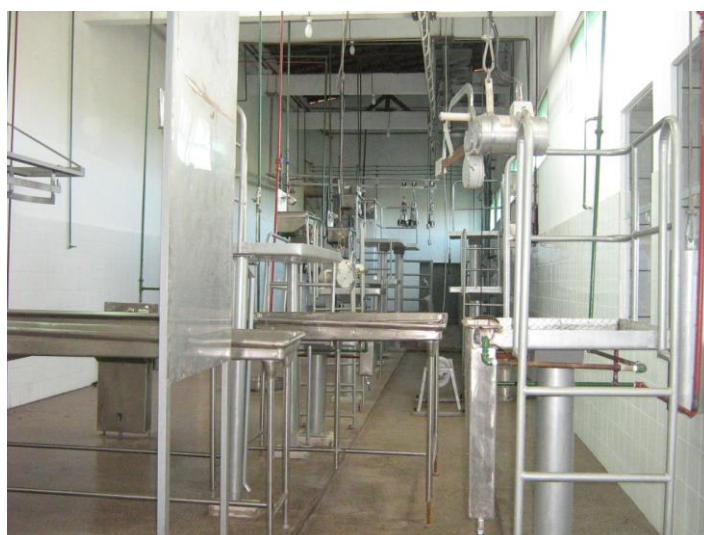
Figura 14 – Equipamentos do frigorífico. Fonte: Santos (2012).
