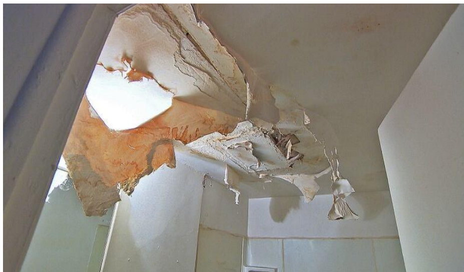
Figura 9- Infiltração Predial. Adaptado de Masset (2025)
