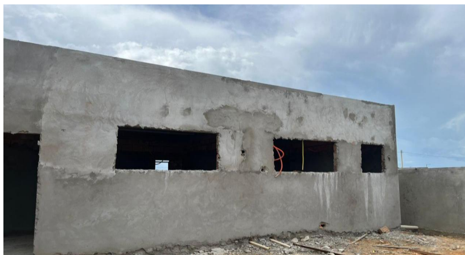
Figura 8 – Reboco. Fonte: Autoria Própria (2024)
