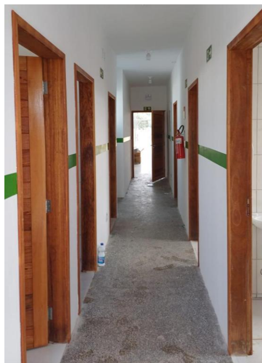
Figura 15 – Corredor concluído e com instalações de proteção contra incêndio. Fonte: Autoria Própria (2024)
