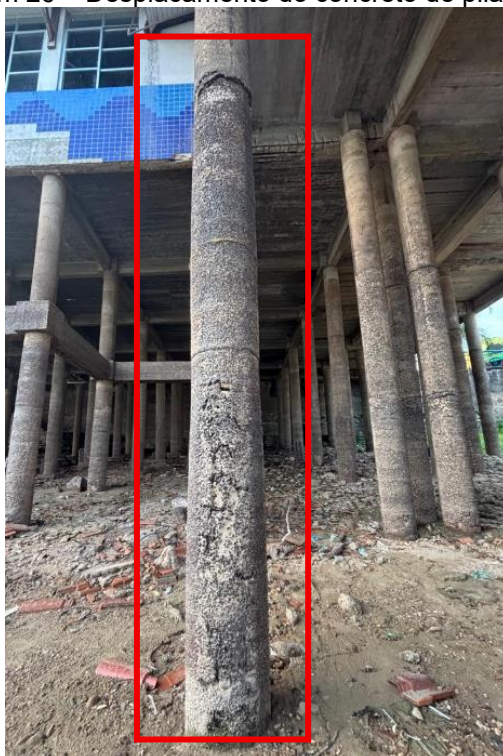
Imagem 26 – Deslocamento do concreto de pilar (P-10)
