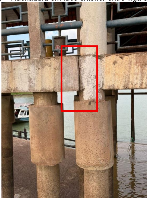
Imagem 21 – Rachadura em face exterior entre viga e pilar (P-05)
