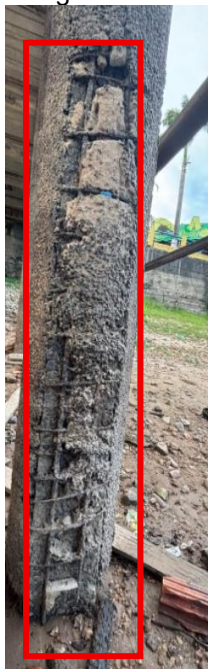
Imagem 30 – Patologia localizada em pilar (P-14)
