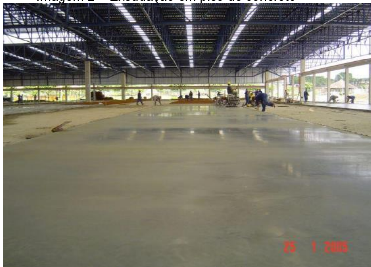
Imagem 2 – Exsudação em piso de concreto
