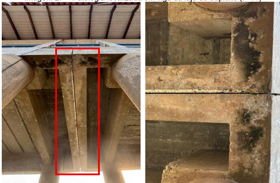
Imagem 27 – Patologia localizada em viga da laje do trapiche (P-11)
