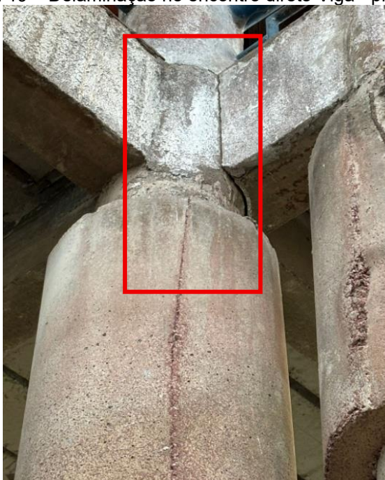
Imagem 19 – Delaminação no encontro direto Viga - pilar (P-03)
