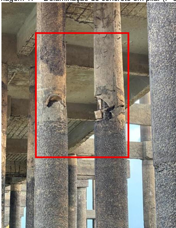
Imagem 17 – Delaminação de concreto em pilar (P-01)
