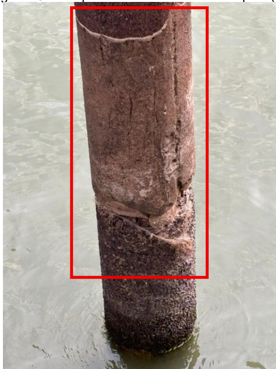
Imagem 18 – Deslocamento de material em pilar (P-02)
