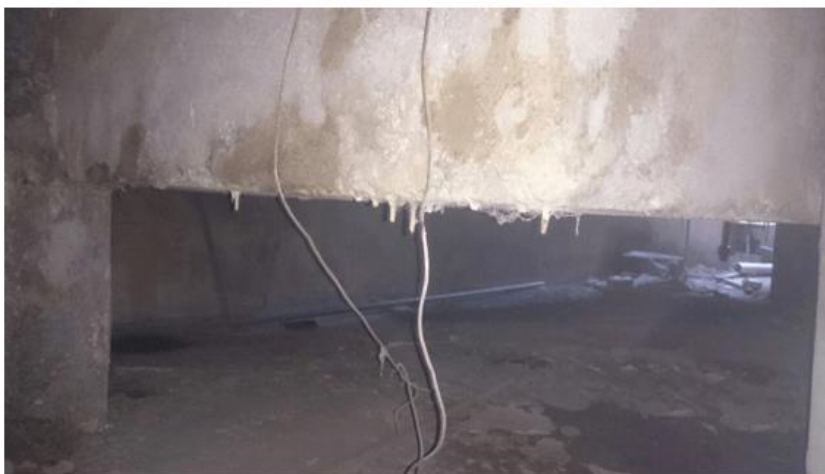
Imagem 11 – Processo de lixiviação em viga de concreto armado
