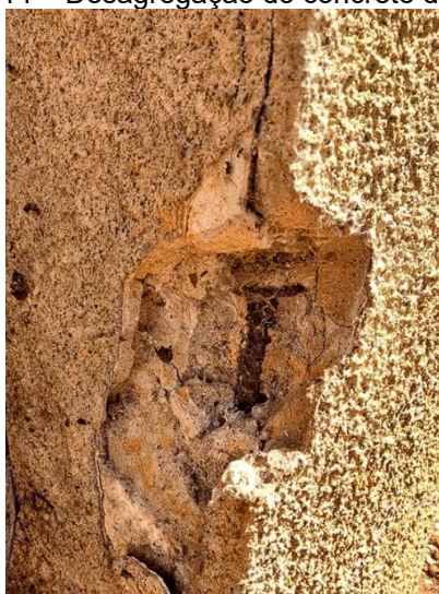
Imagem 14 – Desagregação do concreto de um pilar
