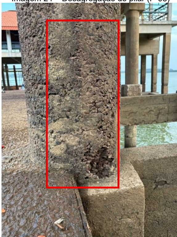
Imagem 24 – Desagregação de pilar (P-08)
