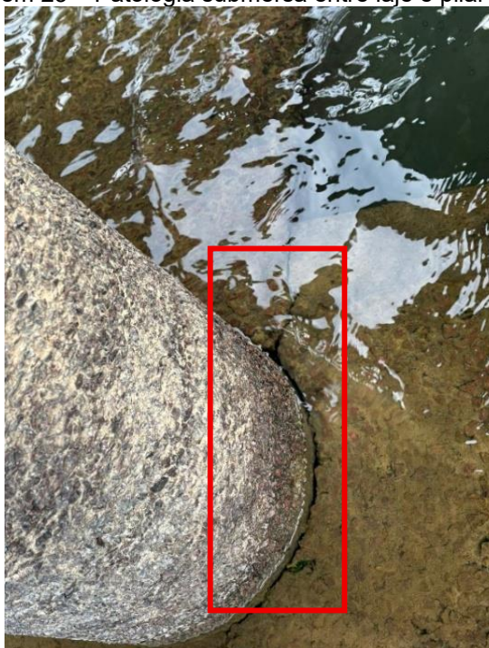
Imagem 23 – Patologia submersa entre laje e pilar (P-07)
