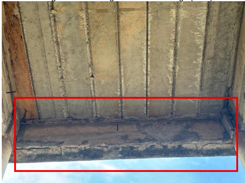
Imagem 32 – Patologia localizada em viga (P-16)
