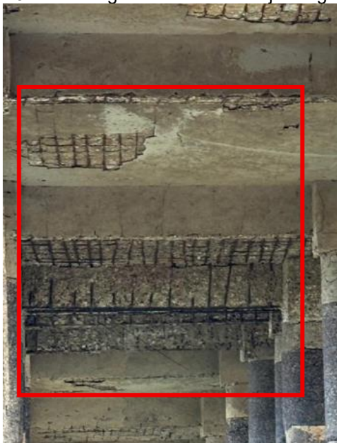
Imagem 31 – Patologia localizada em laje e vigas (P-15)
