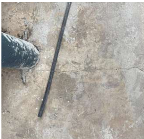
Figura 12 - Fissura localizada junto a um pilar metálico. Fonte: Próprio autor (2025).
