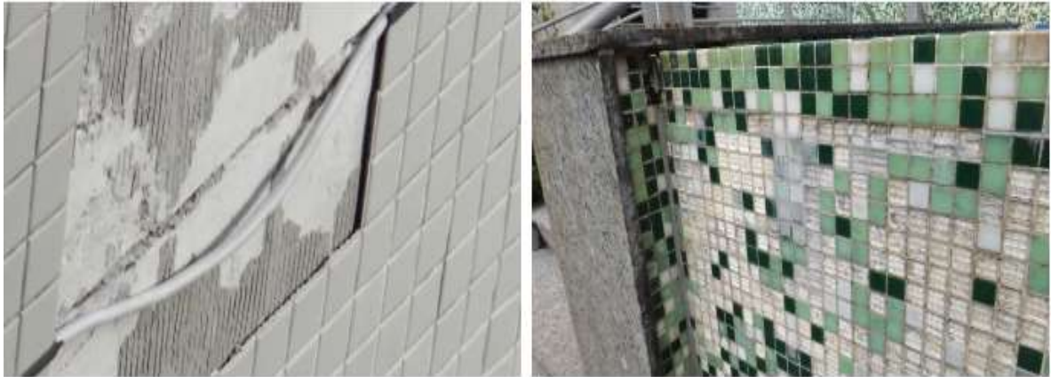
Figura 7 - Destacamento do revestimento cerâmico e destacamento do revestimento em pastilha, respectivamente. Fonte: Saliba e Carvalho Jr. (2019).
