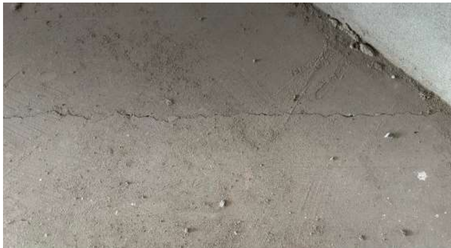
Figura 11 - Fissura transversal no piso interno da feira. Fonte: Próprio autor (2025).
