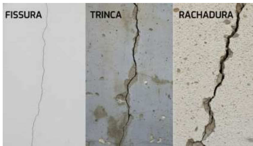
Figura 8 - Manifestações patológicas por recalque. Fonte: Próprio autor (2025).
