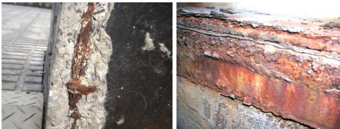
Figura 6 - Corrosão de armadura com deslocamento do concreto e corrosão em estrutura metálica, respectivamente. Fonte: Saliba e Carvalho Jr. (2019).
