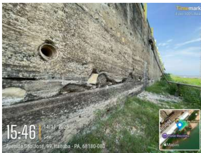
Figura 16 - Rachadura horizontal identificada no muro de arrimo. Fonte: Próprio autor (2025).
