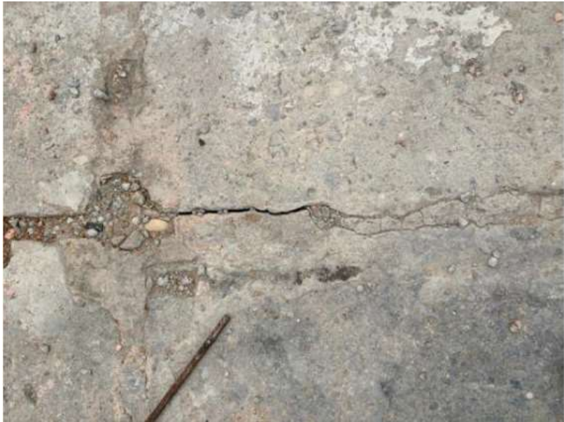
Figura 14 - Manifestação patológica identificada na Feira Beira Rio. Fonte: Próprio autor (2025).
