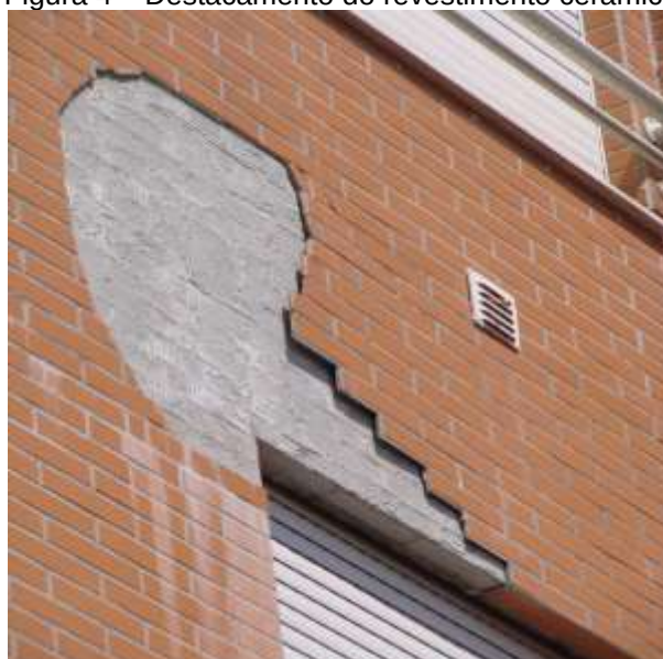
Figura 4 – Destacamento do revestimento cerâmico
