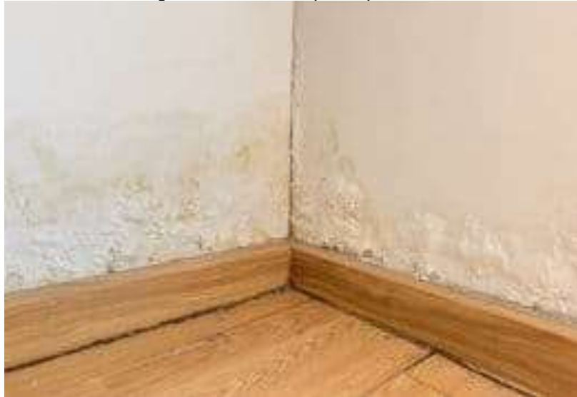
Figura 2 – Umidade por capilaridade
