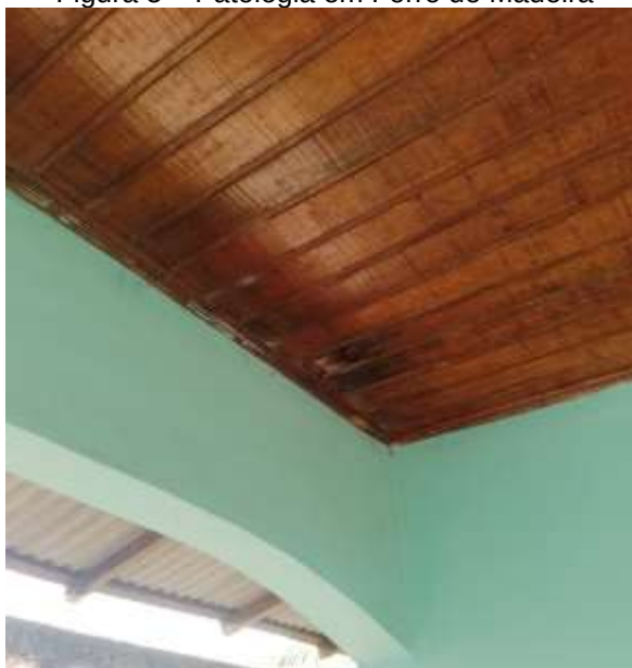
Figura 5 – Patologia em Forro de Madeira
