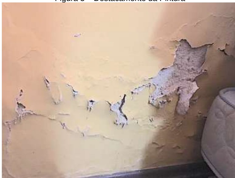
Figura 3 – Destacamento da Pintura
