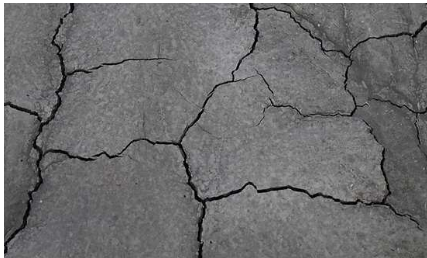
Figura 6- Fissuras em parede geradas pelo recalque diferencial. Fonte: Asope (2012)
